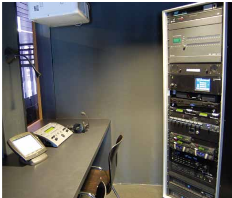
Im Regieraum des großen Hörsaales wurde eine zweite Dockingstation für das drahtlose Bedienmedium installiert.
