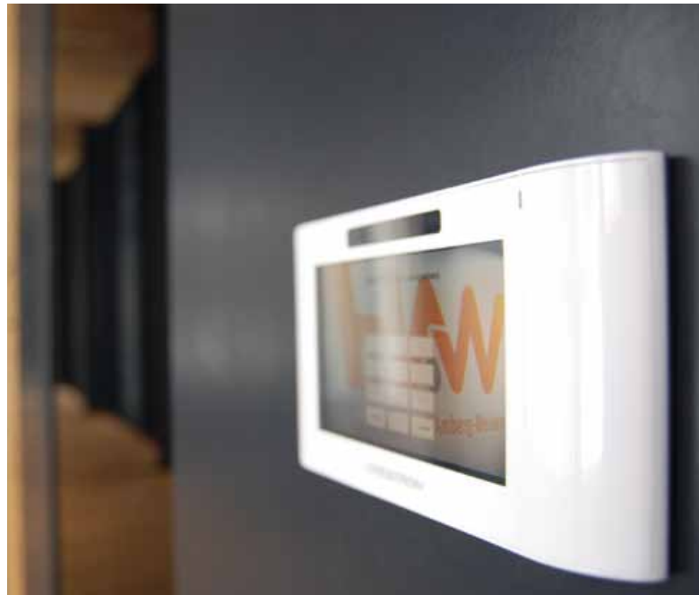
Ein viertes Touchpanel TPMC-4-SM im Eingangsbereich des Gebäudes und wird vom Schließdienst genutzt.
